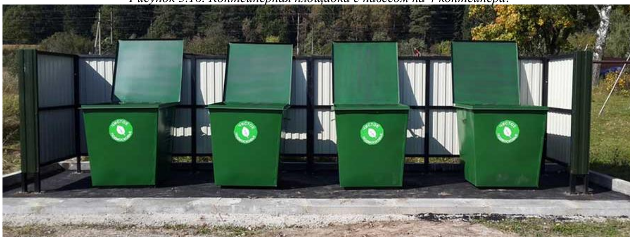
Рисунок 5.17. Контейнерная площадка без навеса на 4 контейнера.
